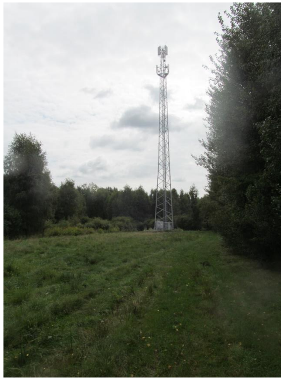
Zał. nr 1: Widok ogólny instalacji radiokomunikacyjnej.
