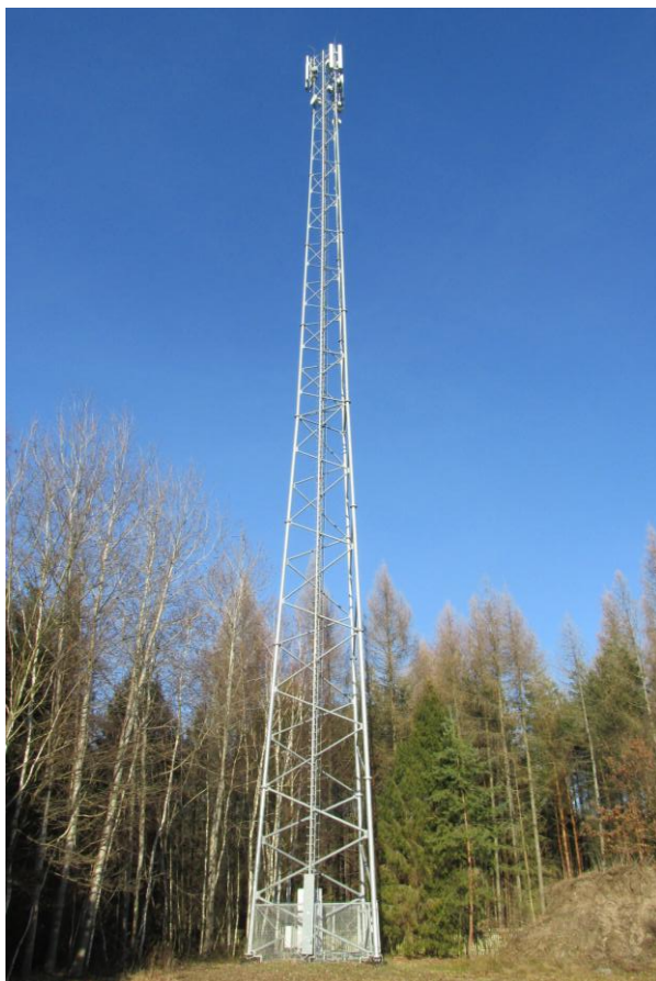
Zał. nr 1: Widok ogólny instalacji radiokomunikacyjnej.
